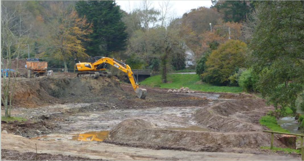
Illustration d'un merlon maintenu en bord de cours d'eau et d'un bassin tampon permettant d'éviter le départ des sédiments vers le cours d'eau durant le chantier. La pelle mécanique reste sur le remblai pour réaliser le décaissement et éviter de tasser le sol de la zone humide (© Brest Métropole).
